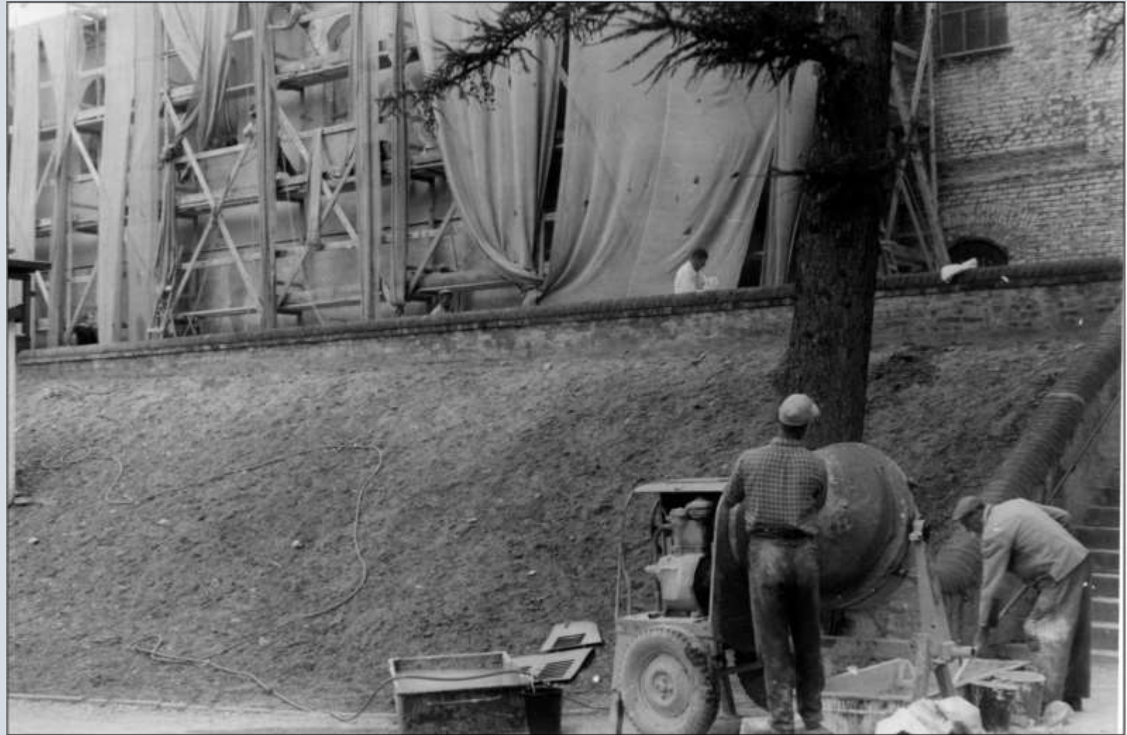
Fotografie Maria Hilf 1960 von Westen während der Verputzarbeiten an der Unterkirche durch Fa. Gebr. Häglsperger (Heimatverein Vilsbiburg)
